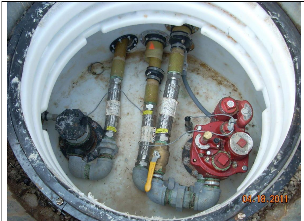
配有空隙传感器的加压应急发电机系统。
