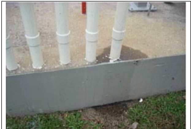
满溢的储油罐可能会导致从通风管道释出
