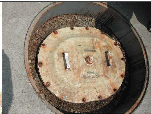
玻璃钢 (FRP) 储油罐顶上的椭圆形集液槽
