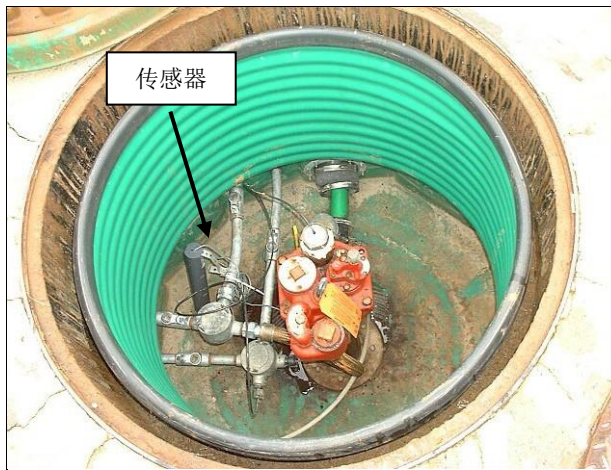
储油罐集液槽的集液槽盖衬垫就位且传感器位置正确
