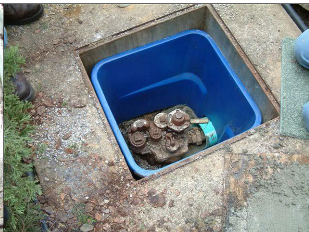
使用塑料容器防止回填物塌陷在泵头上的非密封集液槽。这不符合当前安装标准。
