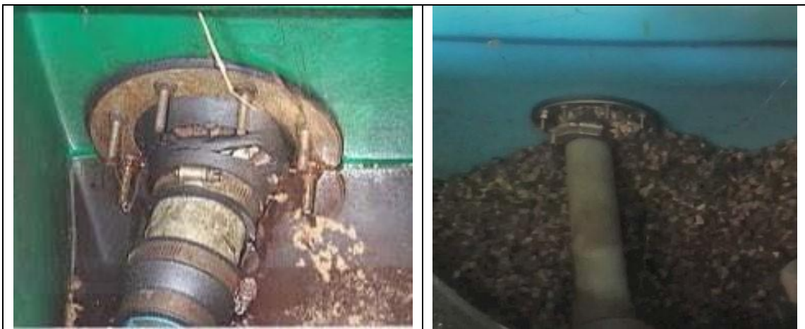
砾石可回填进入集液槽的受损渗透管件如以上照片所示。集液槽已不是液密。
